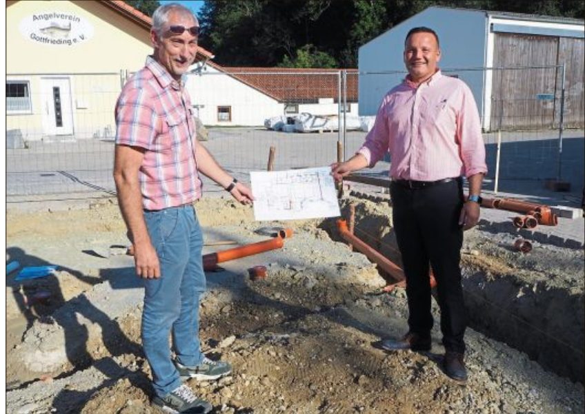
Projektleiter Konrad Hausbeck erläutert gemeinsam mit Bürgermeister Gerald Rost die einzelnen Bauschritte im Detail.
